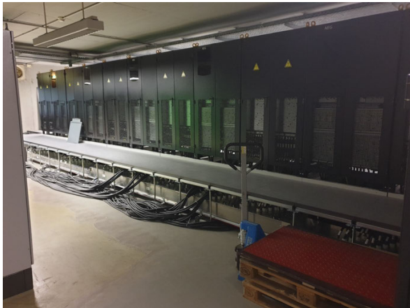
Abb. 3: Umrichter der Netzknoten während des Aufbaus
