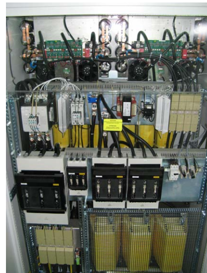
Bild 1: Eingangsstufe der DC-Versorgung: Netzfilter, Netztransformator und Gleichrichter
